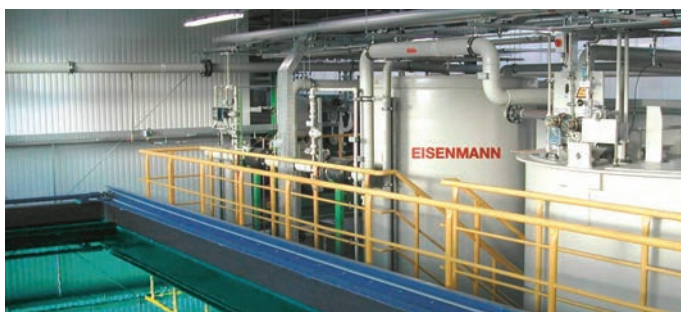
Phosphatfällung in der Chemieindustrie.
