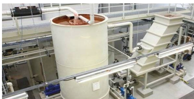
Fentox-Anlage zur Behandlung von pestizidbelastetem Abwasser.
